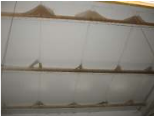
Obrázek 64: Pavučiny v dojárně signalizují nedostatečnou výměnu vzduchu.
