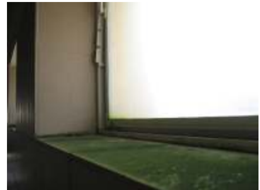
Obrázek 65: Vysoká vlhkost společně s kondenzací vody, vytváří velmi vhodné podmínky pro rozvoj řas.
