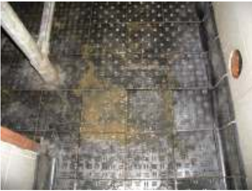
Obrázek 60: Uvolněná čedičová dlažba by měla být co nejdříve opravena.
