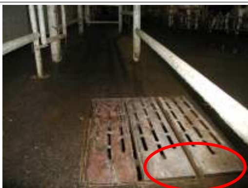
Obrázek 54: Poškozené kanalizační rošty v čekárně, mohou způsobit traumatická poškození nášlapné plochy paznehtu.
