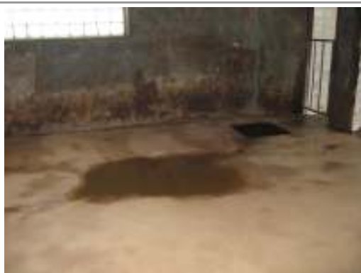
Obrázek 56: Zvlhlé obvodové zdi čekárny a „jezírko“ vzniklé ucpáním kanalizace, by měly být operativně řešeny.
