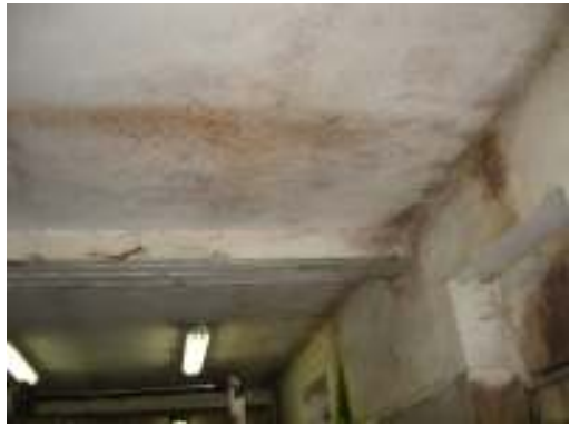
Obrázek 63: Zaplísňené stropy dojírny, vypovídají o nedostatečném provětrávání.
