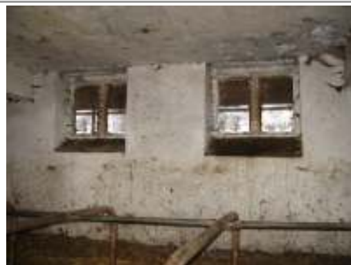
Obrázek 33: V rekonstruovaných stájích by již neměla být okna vyplněná skly.
