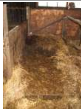
Obrázek 15: Deformovaná vymezení zábrana boxu společně s jeho nedostatečným podestýláním je nepřijatelné a pro dojnice ohrožující.
