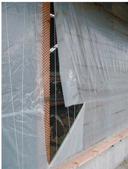
foto 8: Začátek devastace obvodové části stáje.
