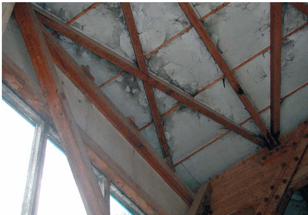
foto 16: Pavučiny jsou indikátorem nedostatečné výměny vzduchu.
