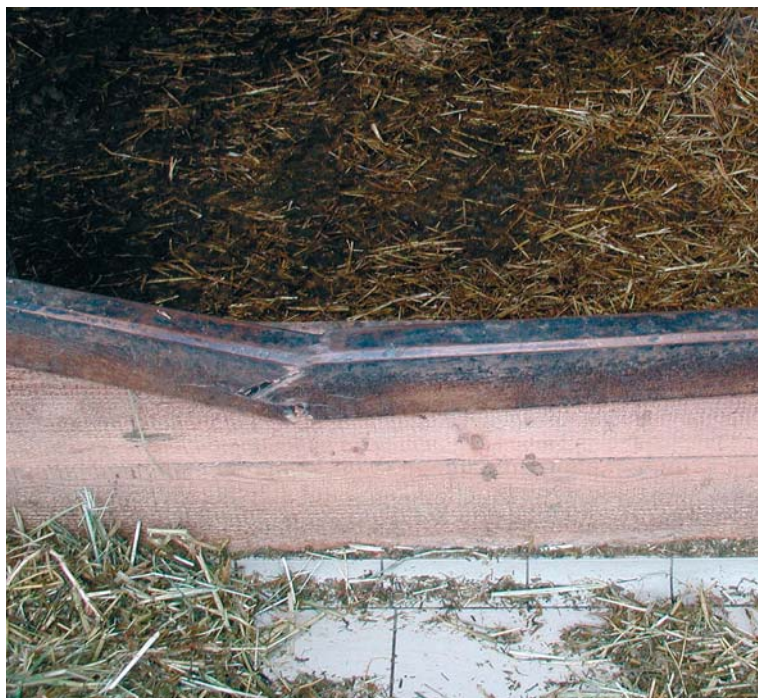
foto 18: „Prasklá požlabnice“ je příčinou možného poranění zvířat.
